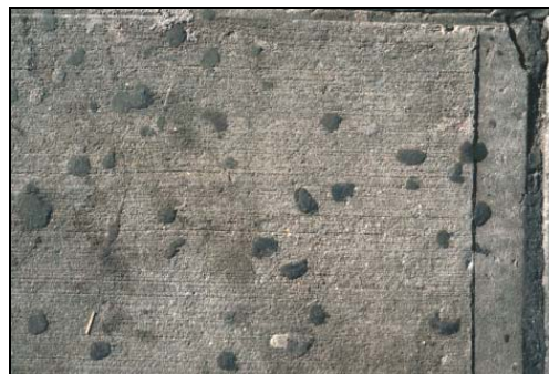
Изношенный камень: уложенный бетоном тротуар
